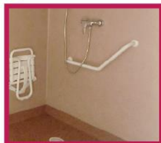
Barre d'appui dans la douche
