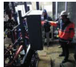
Raccordement aux réseaux urbains alimentés par la chaufferie Biomasse.
